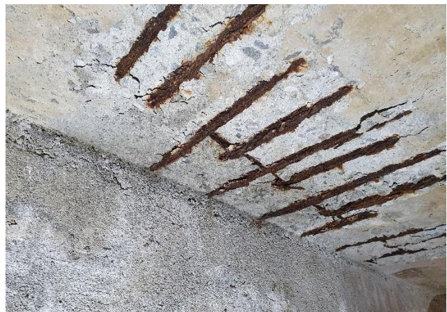
Foto 6: Espulsione di copriferro e armature corrose con perdita di sezione
