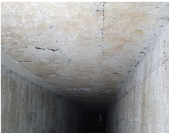
Foto 5: Espulsione di copriferro e processo di rigonfiamento delle armature attivo
