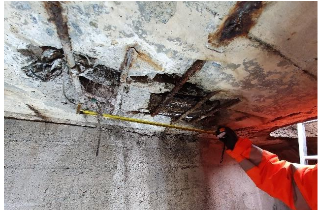
Foto 4: Armature corrose con perdita di sezione
