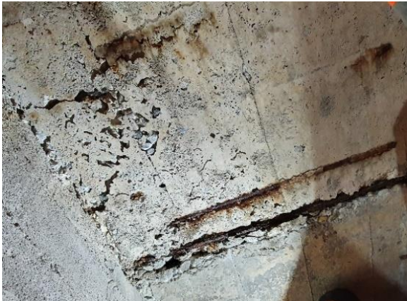
Foto 3: Porosità del calcestruzzo, espulsione di copriferro e armature corrose con perdita di sezione
