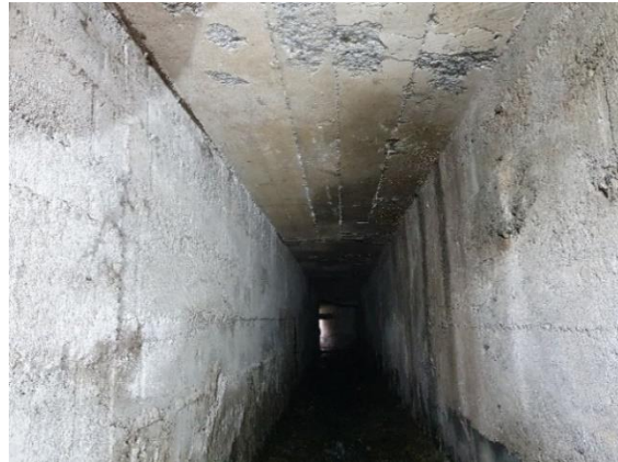
Foto 2: Porosità del calcestruzzo e distacchi locali della pellicola cementizia
