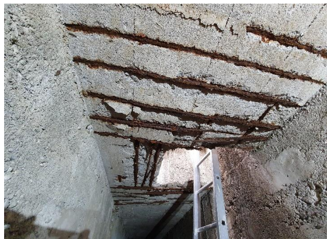
Foto 8: Espulsione di copriferro e armature corrose con perdita di sezione
