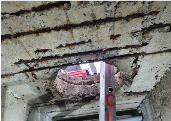
Foto 1: Espulsione copriferro, armature corrose, riduzione sezione barre.
