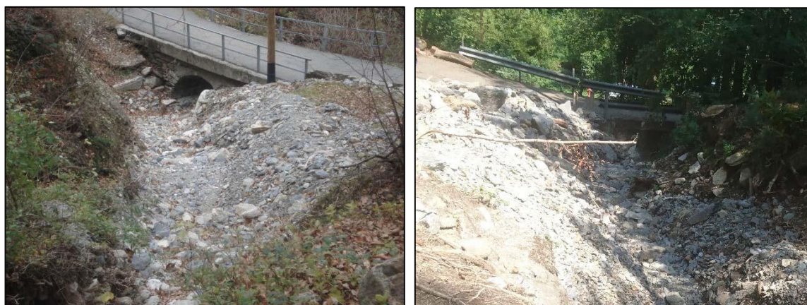
Figura 3: ponte su Via Bedruscio e ponte per strada Novella (viste da monte a valle)
